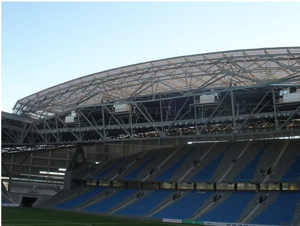
Copertura Stadio, Astana (KZ) – 2007 – esempio di realizzazione con l'impiego delle lastre Macrolux® Multiwall.
